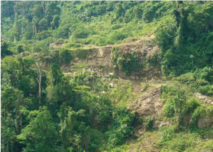
Foto 5 - Fenomeni di "toppling" dalle bancate di arenaria sul sito della spalla nord del viadotto
