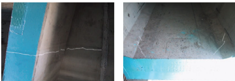
● Fig. 4 - Tipica fessurazione in testata di cassoncino ferroviario. ● Fig. 4 - Typical cracking in the railway box-beam end.
